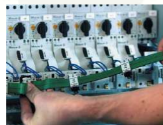
Надежная установка и электромонтаж
