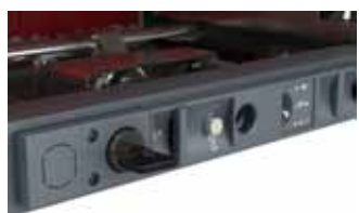
Блокировка в положении «выкачено» с помощью встроенного замка
